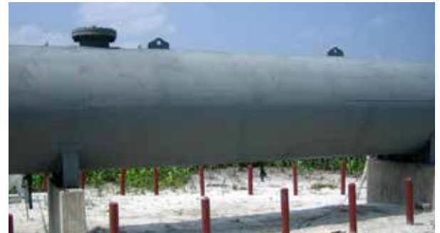
Cuve recouverte de Belzona 6111 conférant une protection cathodique à la surface métallique
